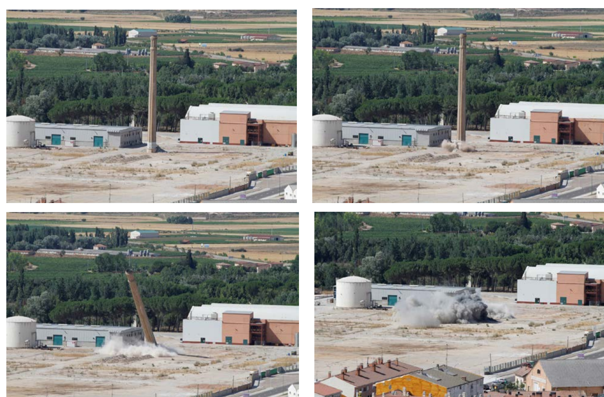
UNA SECUENCIA DEL ÚLTIMO VESTIGIO DE LA FÁBRICA: LA CHIMENEA, QUE PODÍA HABERSE CONSERVADO COMO UN RECUERDO DE NUESTRO PASADO INDUSTRIAL.
