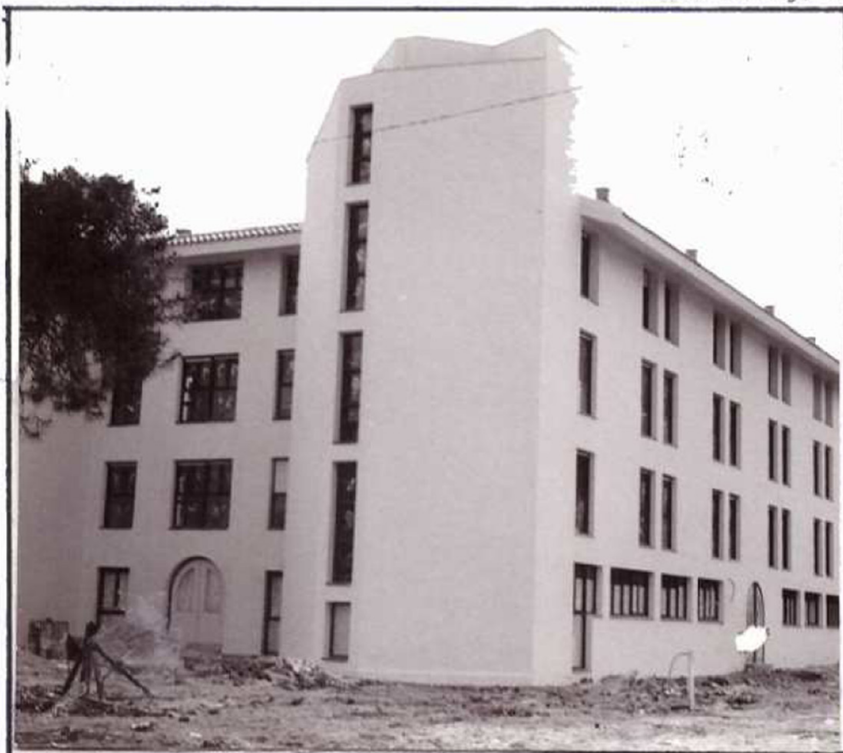
RESIDENCIA DE ANCIANOS. Fotografía del estado actual del edificio que se está construyendo en la Avenida de la Residencia.
